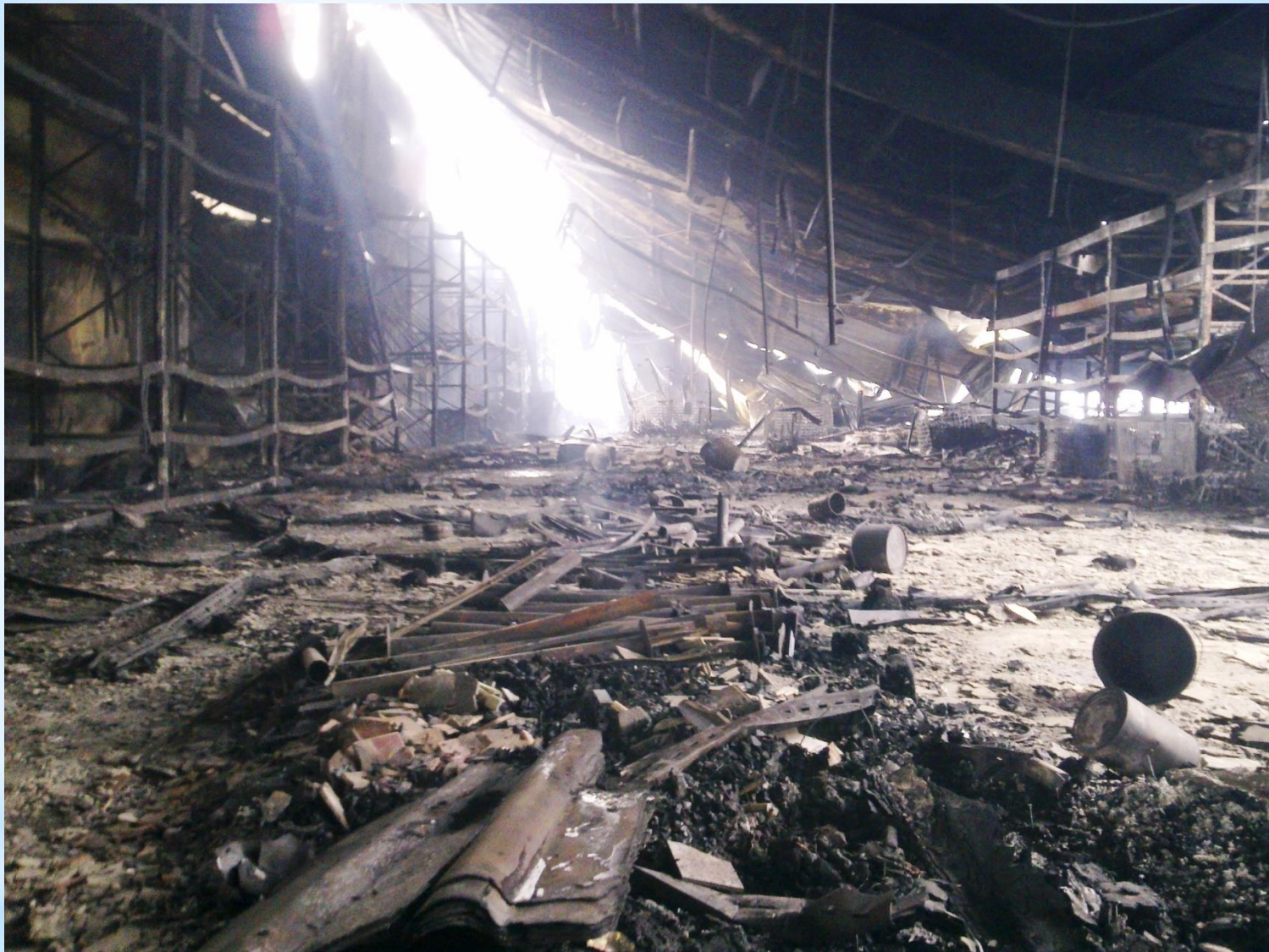
Фото 4 – Загальний вигляд зони термічних руйнувань в торговельній залі зі сторони центрального входу на глибину приблизно 30 м від стіни головного фасаду.
