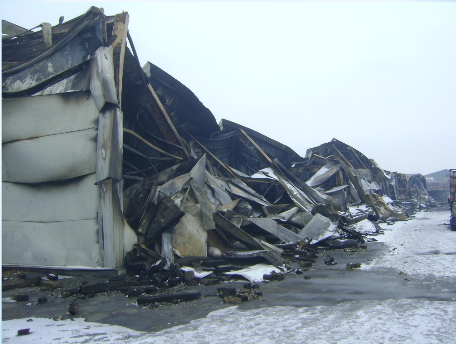
Фото 3. – Зона суцільних завалів будівельних констру-кцій, що виникла внаслідок пожежі з тильної сторони будинку.
