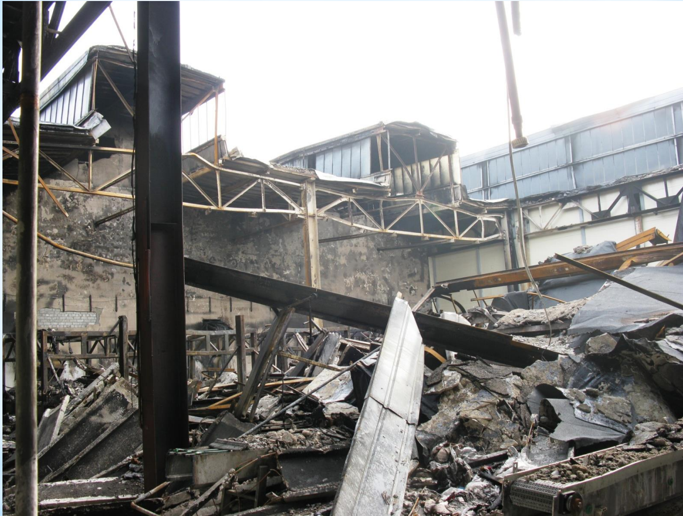
Фото 2. – Сліди температурної деформації металевих ферм покриття, що збереглися в осі 41 рядів К/Л-П: 1 – металеві ферми покриття зі слідами деформації.
