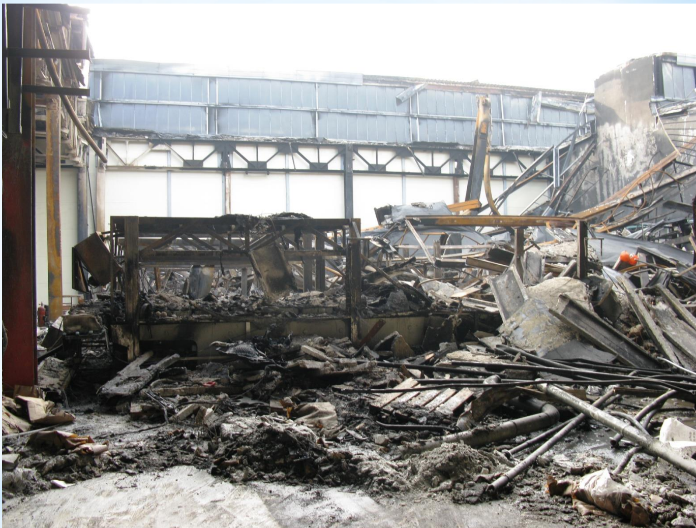
Фото 1. – Зона руйнування покриття ділянки БФ № 3 в осях 36-41 і рядах К/Л-П та металевих колон в осях 37-40 рядів Л-Н: 1- перегородка, яка наведена після пожежі по ряду П між ділянкою БФ № 3 та іншою ділянкою БФ; 2 – металеві ферми покриття по ряду П без слідів температурної деформації.
